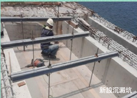
排水溝渠截流系統
